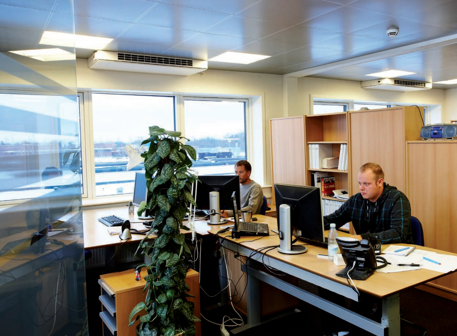
I kontorlokalet er det installert to AM 300-ventilasjonsanlegg, der 2/3 av anlegget er integrert i taket.
